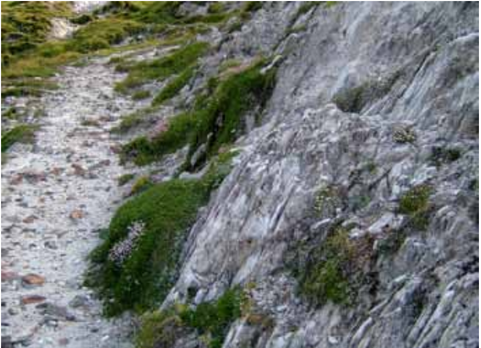
Fenomeno di erosione nella zona di contatto
